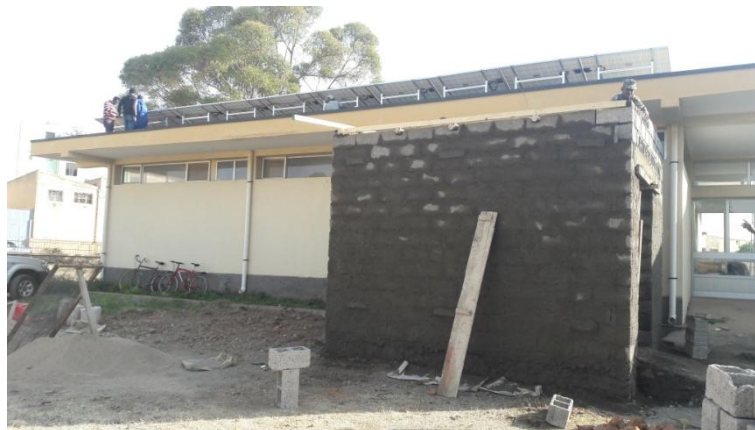
Das Akku-Häuschen an der Brandverletztenstation
