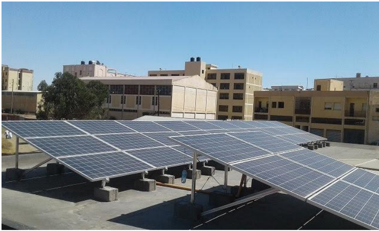
Bereit für die Inbetriebnahme
