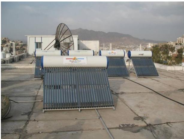
1: Die Solar Kollektoren zur Warmwasserbereitung schenkte die Fa. Aschoff GmbH Solar, Rosenau 13, 91580 Petersaurach
